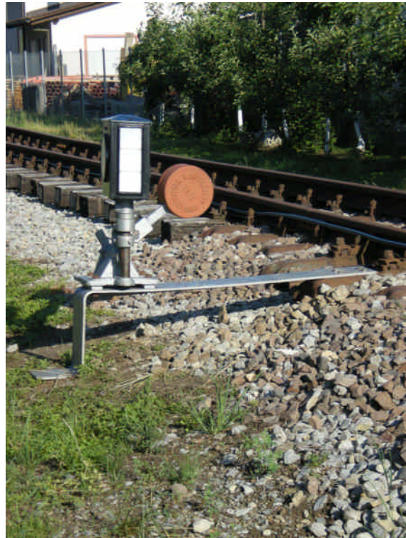
Die Stelleinrichtung ist inzwischen auch montiert. Noch fehlt die schwarz-weiße Lackierung am Stellgewicht. (Bild: Stefan Haag)
