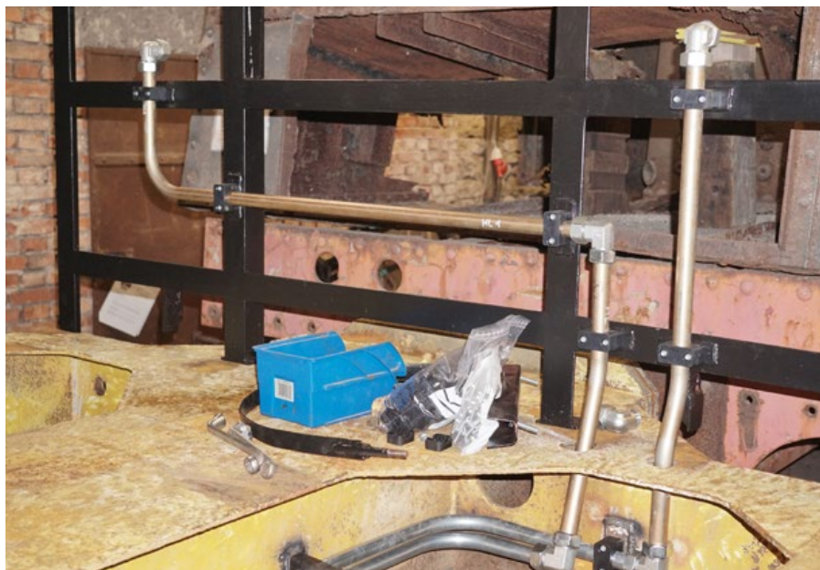
Die neue Druckluftverrohrung / Stefan Haag
