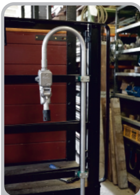
Steckverbindung mit Leerrohr am Bühnengeländer (Bild: Stefan Haag)
